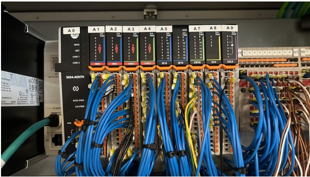
Modułowy system I/O Allen-Bradley z gęstym okablowaniem sygnałowym.
